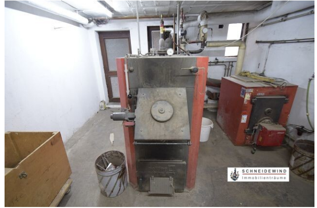
k-47 Links Biomassenheizung und rechts Öl Heizung
