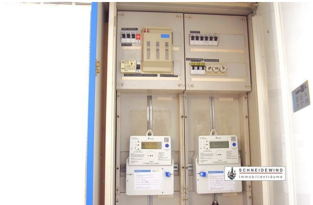
k-42 Sicherungsschrank mit Zähler Büro und Halle
